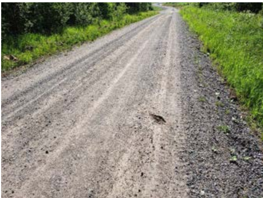
Figur 22: En spricka i vägmitten av sträcka 3 och en block-/tjälskada vid 300 meter. Foto: Håkan Arvidsson, VTI.
