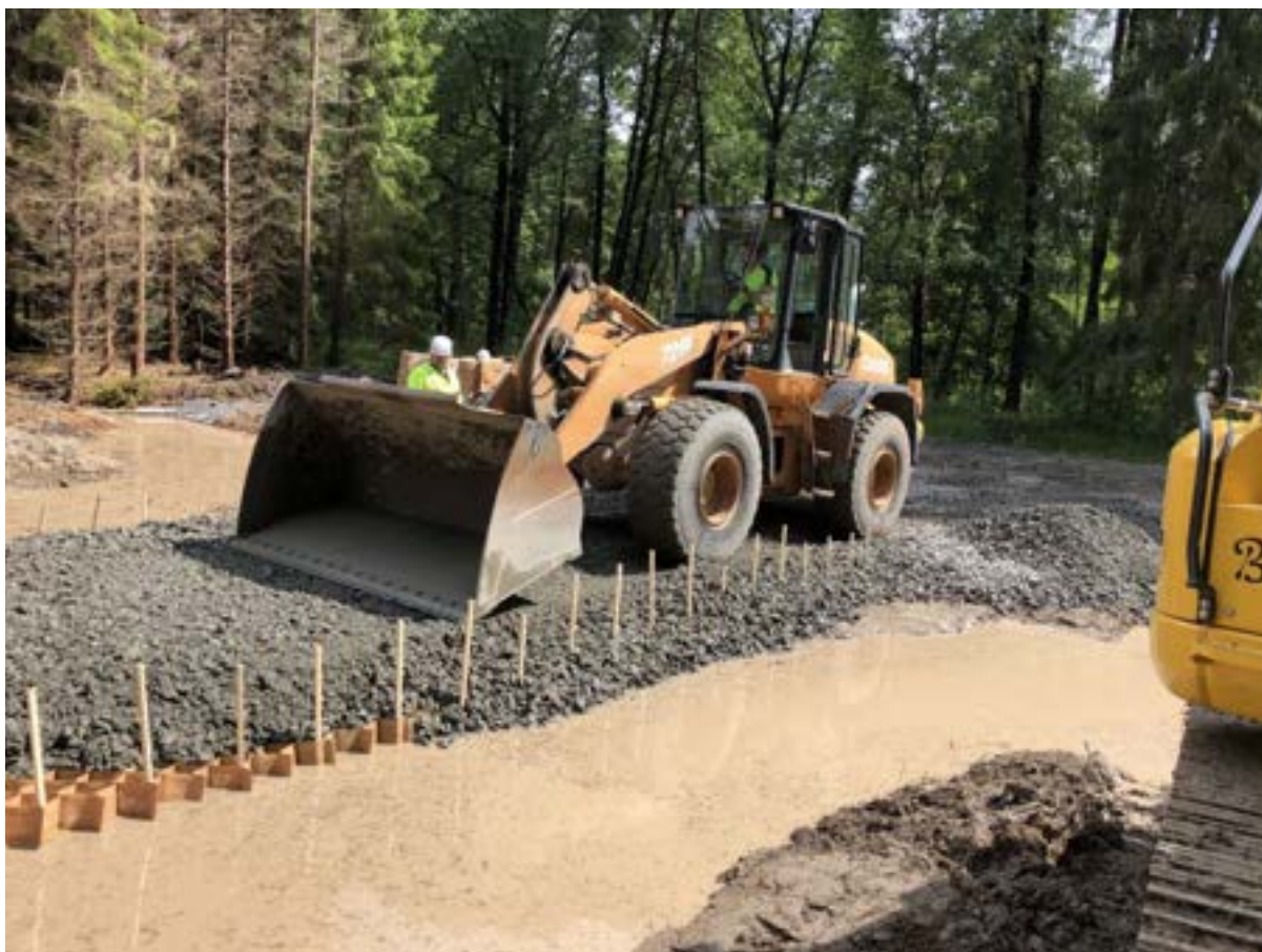
Figur 87: Geocellerna och överbyggnaden låg i vatten på finjordsrik underbyggnad vid byggnation i Grums. Foto: Mikael Hindrikes, Stora Enso.
