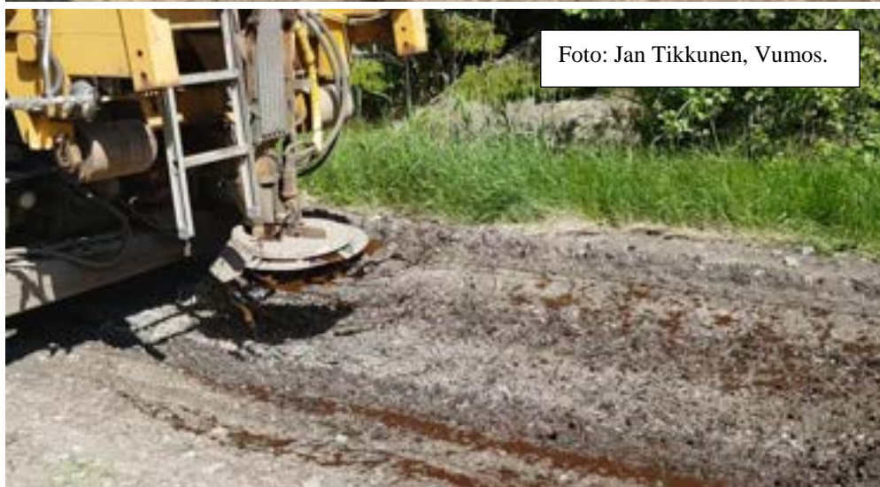
Figur 36: Stabilisering av en utvald skogsbilväg i Trosa med hjälp av låg miljöpåverkan tillsatser.
