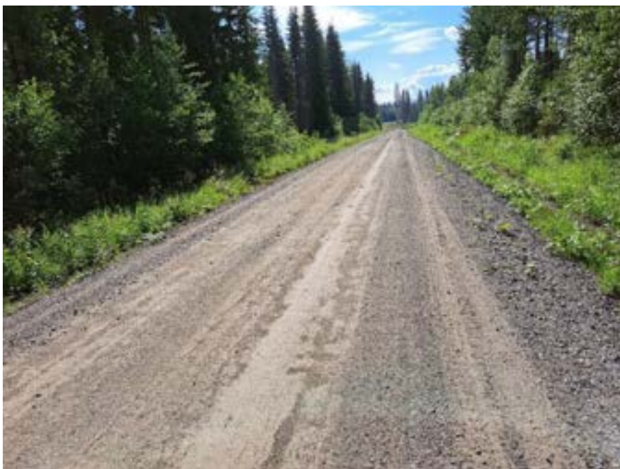
Figur 20: Sprickor noterades i både vägmitt och höger väkant vid 245–265 meter av sträcka 3. Foto: Håkan Arvidsson, VTI.
