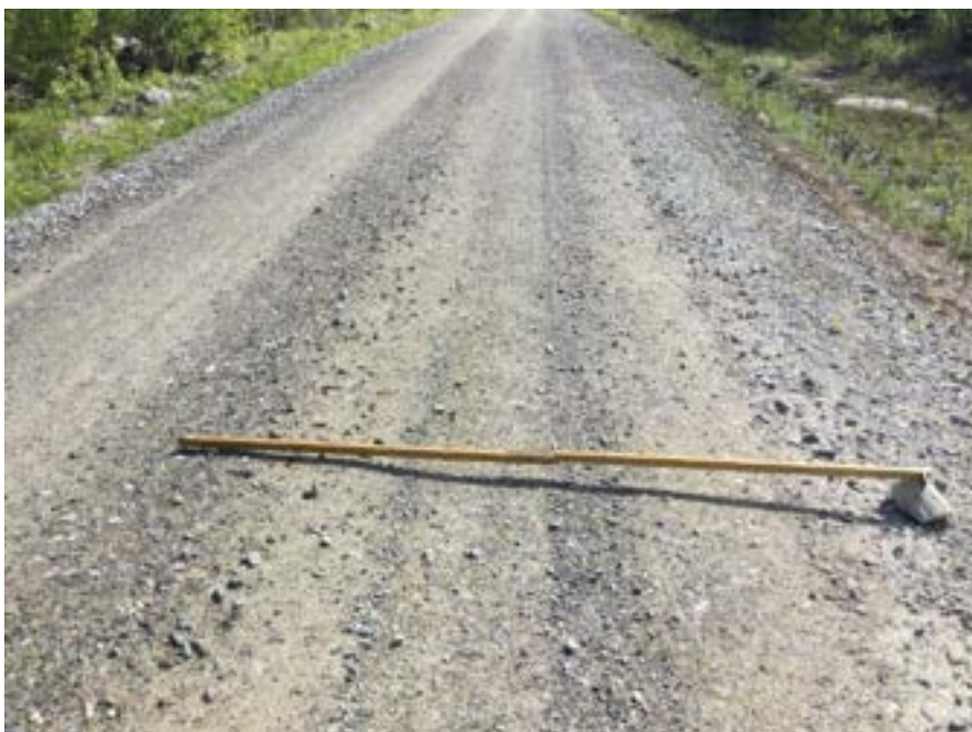
Figur 7: Vägsträckan med 5 % bombering som byggdes av SCA i Ånge. Foto: Tomas Johansson, SCA.
