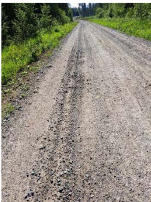
Figur 21: Sprickor i vägmitt av sträcka 3 samt antydning till pothål till höger. Foto: Håkan Arvidsson, VTI.
