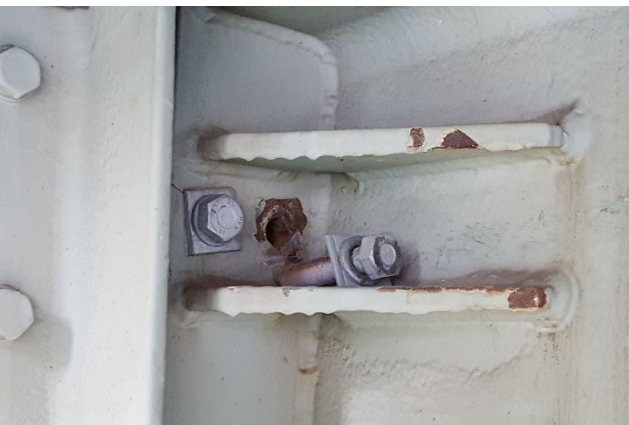
Brott i skruvar.
