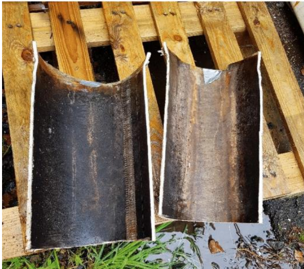
Figur 6-21. Filtfoder installerad 1995 med en nedbruten och missfärgad inre film av polyuretan. I vattengången är den bättre bevarad. Innan tvättning med högtryckstvätt.
