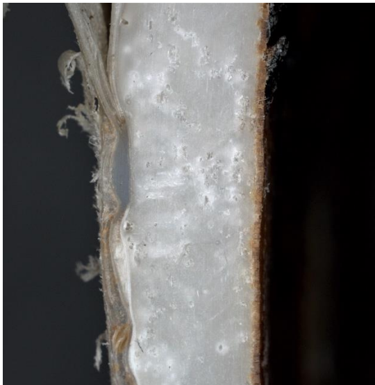
Figur 6-39. Foder som varit installerat sedan 1995 på Öckerö uppvisar endast mindre mängd små porer och vitning.
