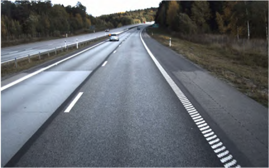
Figur 48. Foto sektion ca 19/500 för E20, K1, östergående riktning (TPL Marielund – TPL Härad), skarv mellan betong och asfalt.
