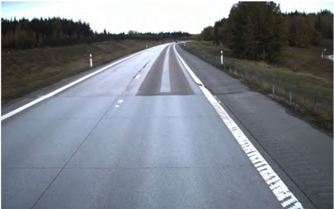
Figur 54. Foto sektion ca 33/750 för E4:an norrgående riktning förbi Uppsala, skarv mellan betong och asfalt.
