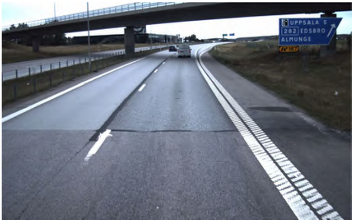
Figur 52. Foto sektion ca 11/860 för E4:an norrgående riktning förbi Uppsala, skarv mellan asfalt och betong.
