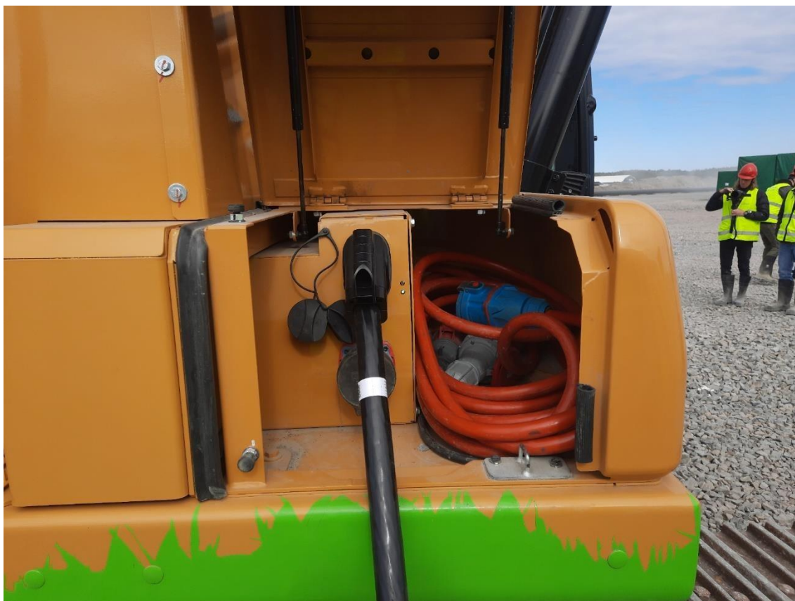
Figur 4: Laddanslutningen på grävmaskinen.
