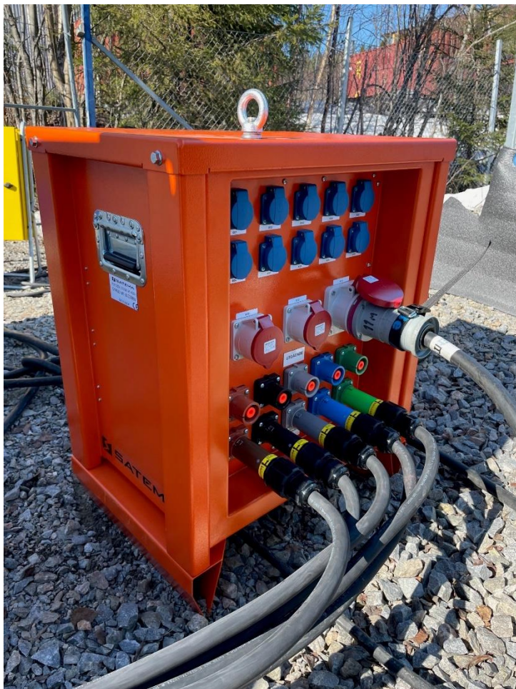
Bild 3: Bilden visar kopplingskåpet tillhörande Typ 1 energilager
