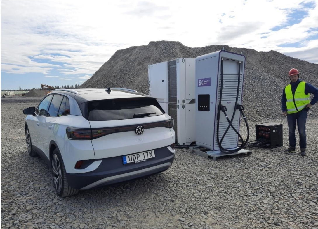
Figur 3: Energilagerenheterna, snabladdaren och ID.4 (kopplingskåpet syns bakom laddaren).
