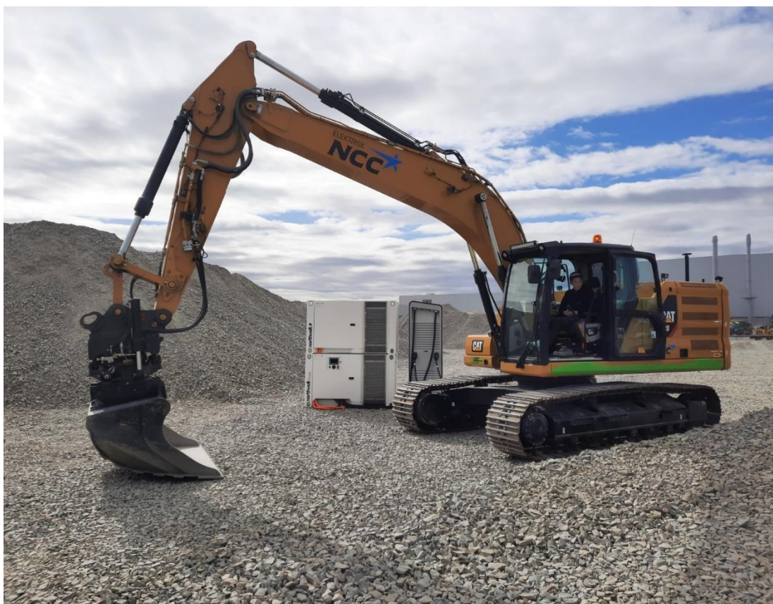
Figur 1: På bilden ser man energilagret och snabbladdaren bakom grävmaskinen.
