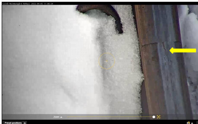
Figur 8. Spricka med längd 20 mm, Övervakningsbild tagen med OH-kamera i syfte att bevaka spricktillväxt.
