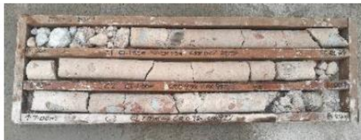
Figur 10: Kärnprover från kc-pelare med genomgående sprickor och krossade partier. Foto Yohannes och Daramalinggam (2019(a)).
