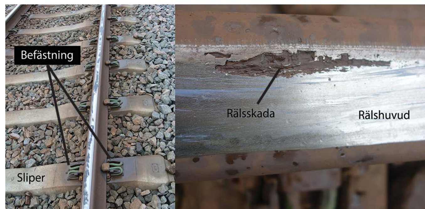
Figur 2 Befästning av typen fastclip och spårskador på rälshuvud.
