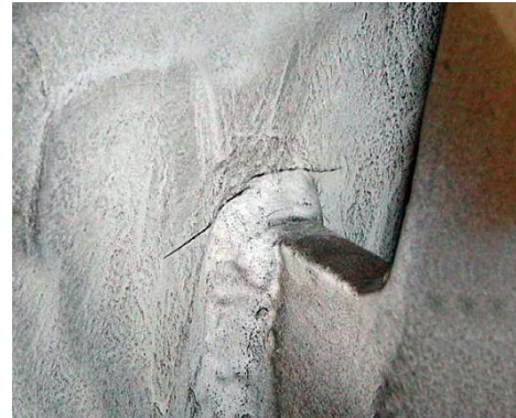
(b) Spricka i balkliv vid svets.
