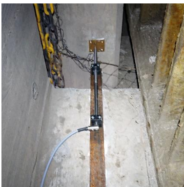
(a) En installerad förskjutningsgivare.
